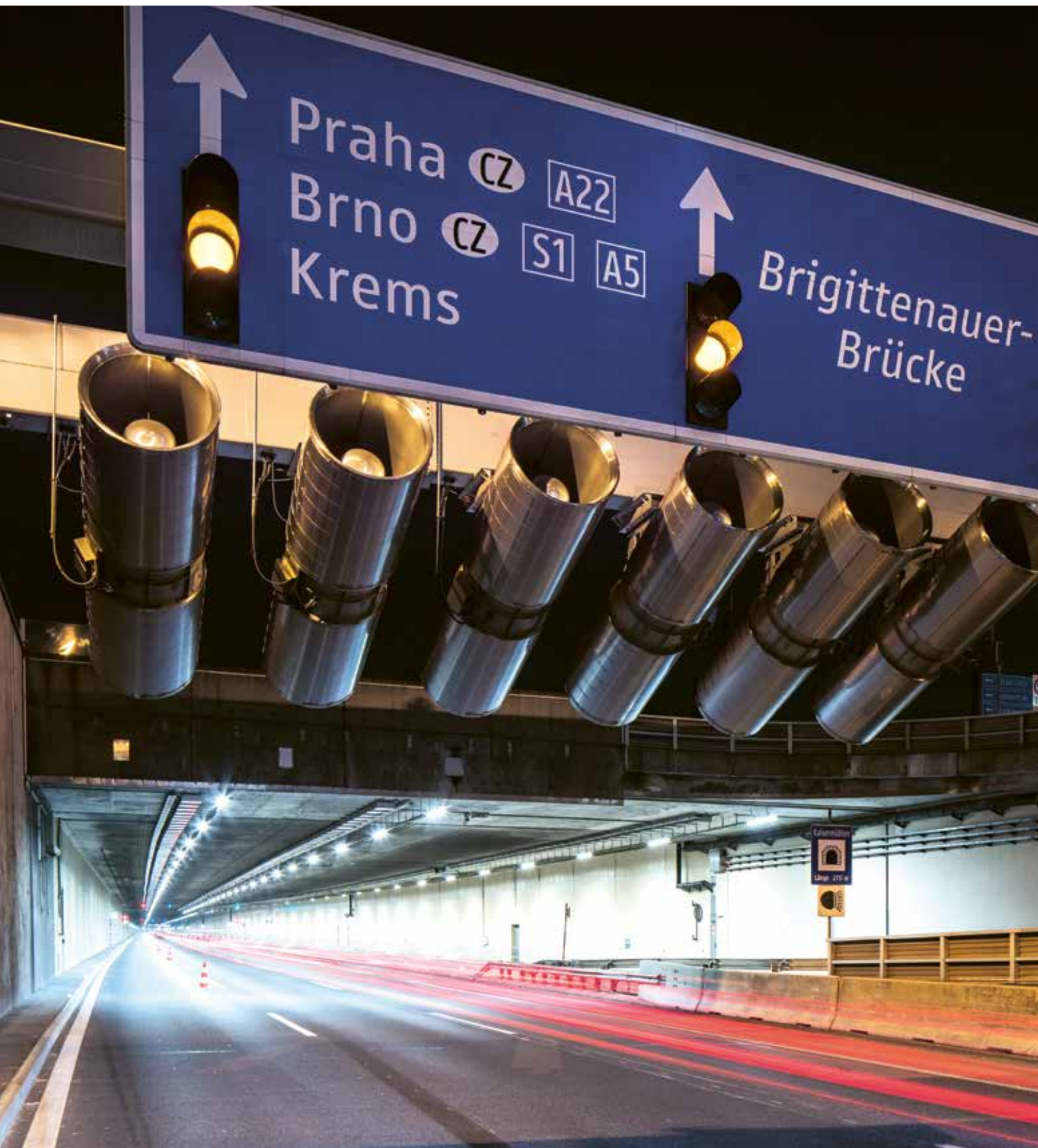
Projet : Kaisermühlentunnel, Vienne, Autriche Produit : Tunnellight TL 23
